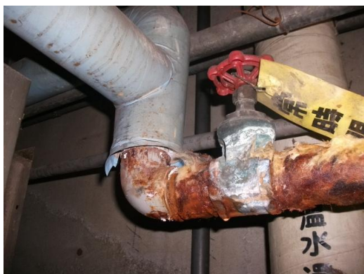
バイパス弁漏水箇所
