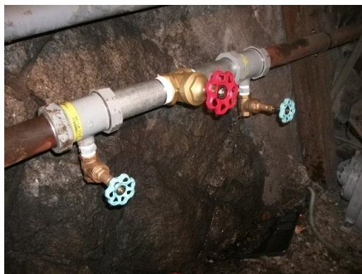
漏水調査バルブ
